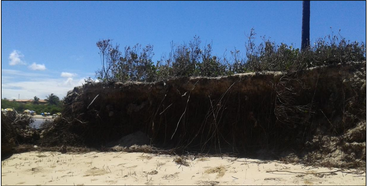
Figura 22 - Trecho vulnerável à erosão, na Barra de Praia do Forte
